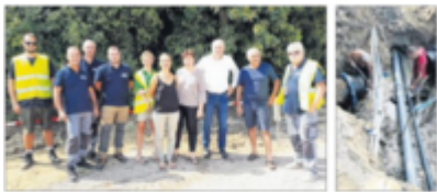
Sébastien Luciani, le président de l'OEHC, est venu sur le site de la rupture de canalisation pour constater les dommages et leur efficacité.
